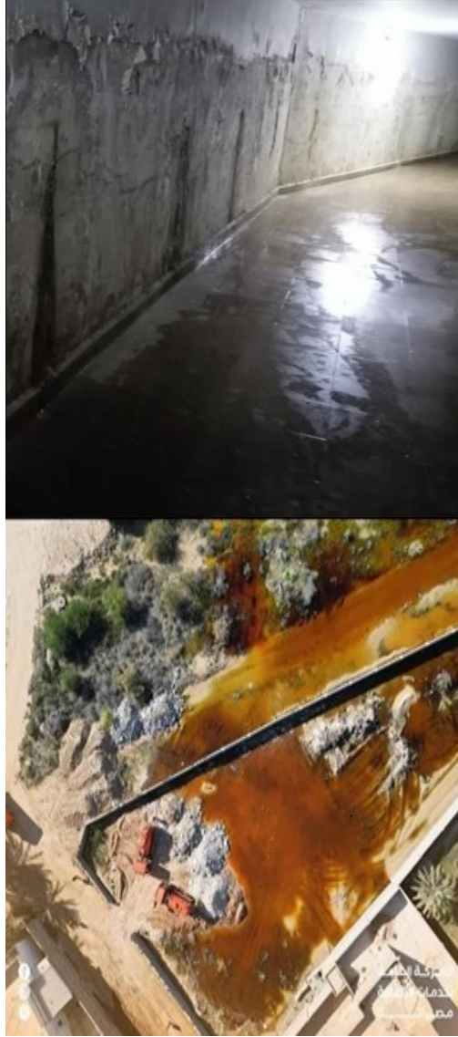
الشكل (6). تظهر المياه الجوفية على مستوى السطح.
